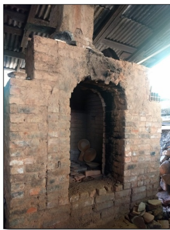
Figura 6: Forno a lenha utilizado por Moacir “Ci” para queimar as peças. Foto: Edmara Schuch, out. 2019.
